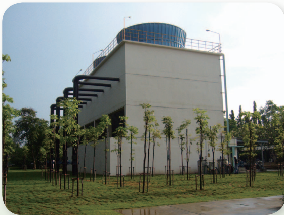
圖為本公司在泰國暹羅建設的餘熱發電項目
